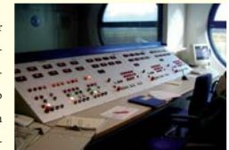
Steuerstand eines Pumpwerkes
