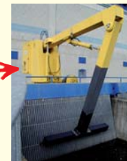
Rechen mit Rechenreinigungs-anlage
