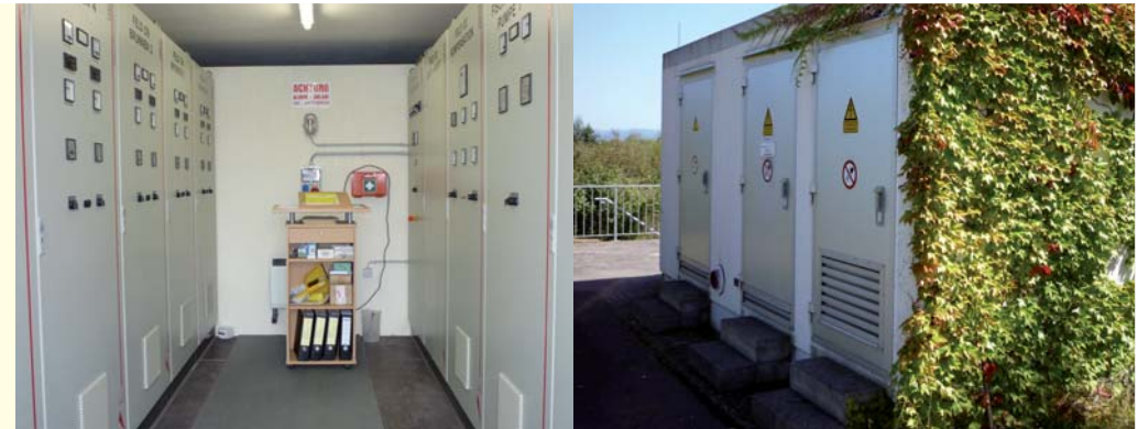
Stromversorgungsstation, Innen- und Außenansicht
